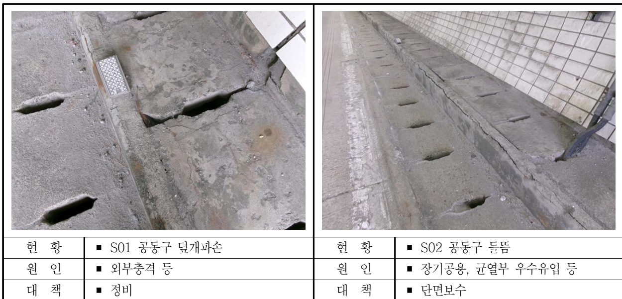
【사진 1.3.8】 공동구 손상현황
