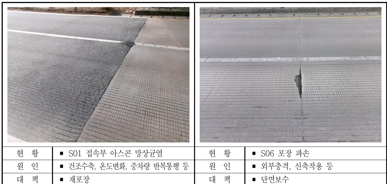
【사진 1.3.12】 포장부 손상현황
